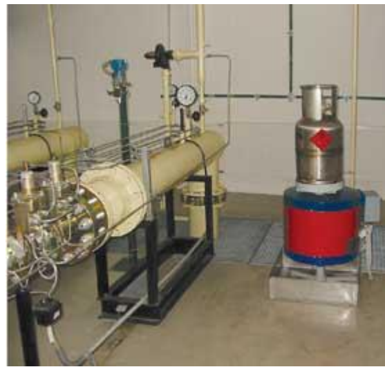
Obr.3.2 Príklad využitia odparovacieho odorizačného zariadenia na STL výstupe
